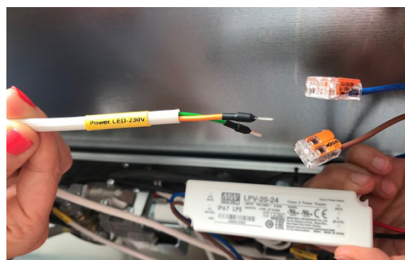
Sluit elk van de 2 kabels op één van de wago schakelaars (kleur speelt geen rol)
